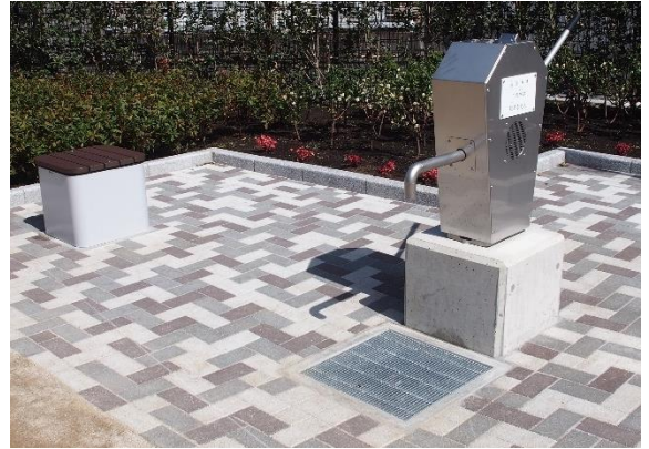
マンホールトイレ(ベンチ)と雨水ポンプ
