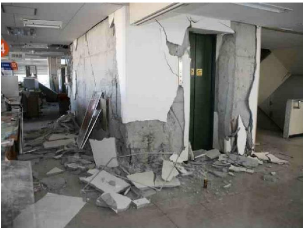
東日本大震災における須賀川市役所庁舎の被害
