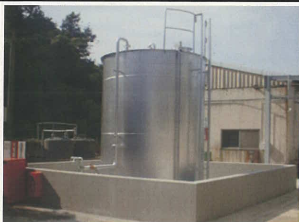
※ 屋外にある貯蔵タンクで危険物を貯蔵する施設
