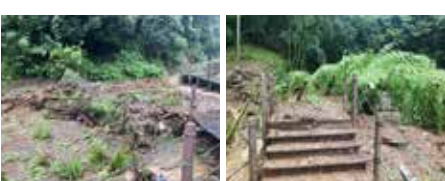
令和6年8月末の台風10号により被害を受けたせせらぎ公園の様子
