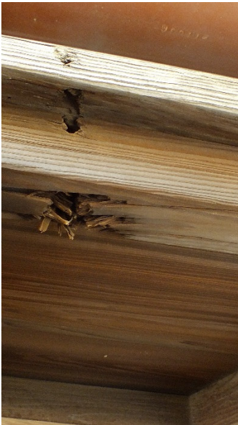
1 階東側庇を弾が貫いた痕
