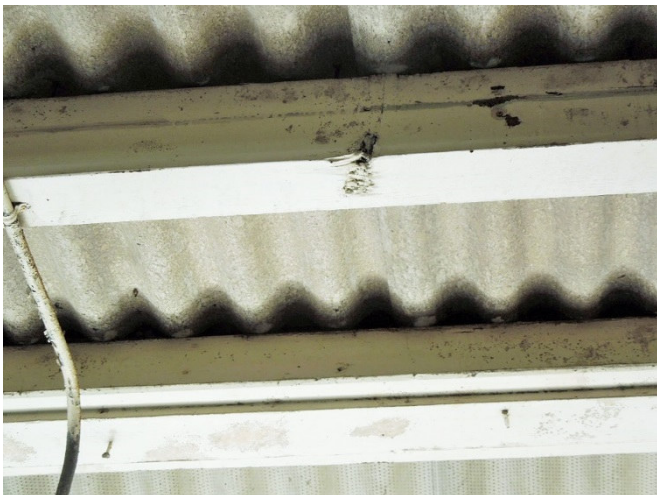
天井の梁に残った機銃掃射の痕 2
