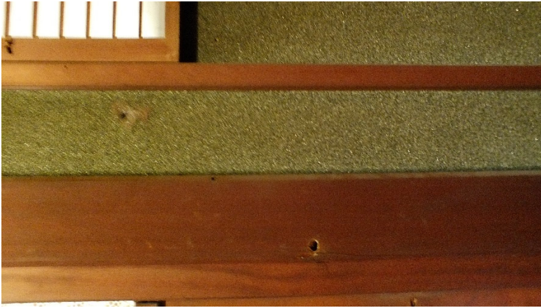
2 階東の 8 畳間。広縁側（海側）の壁には西から東へ斜めに 5 か所の弾の痕があり、弾は壁を突き抜けていました。
