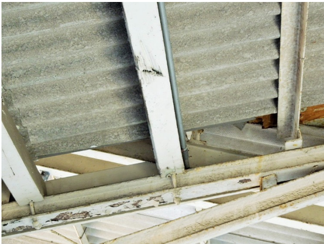
天井の梁に残った機銃掃射の痕 1
