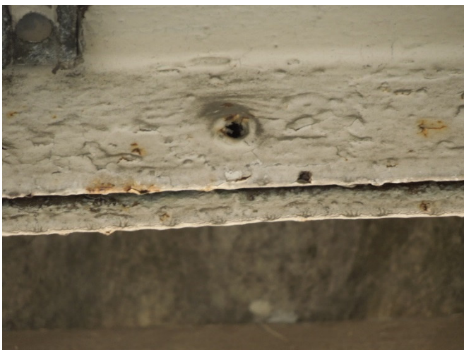
天井の梁に残った機銃掃射の痕 3
