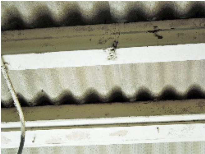
天井の梁に残った機銃掃射の痕 2
