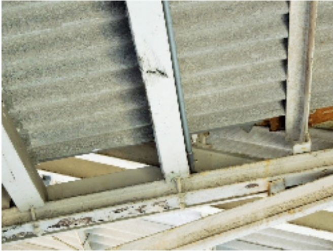
天井の梁に残った機銃掃射の痕 1
