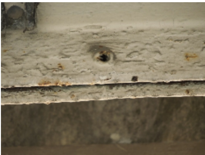
天井の梁に残った機銃掃射の痕 3
