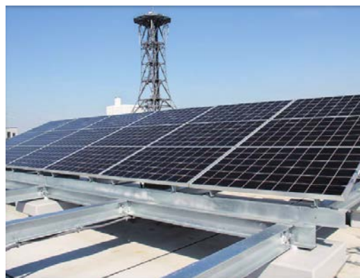
図 太陽光パネル（千葉県白石市）
