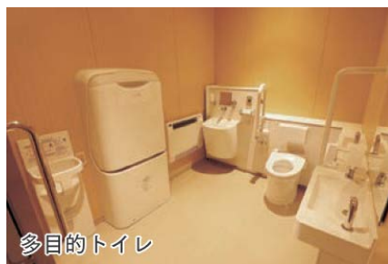
図 多目的トイレ（長野県中野市）
