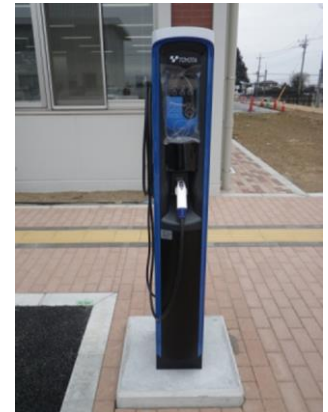
充電ステーション
