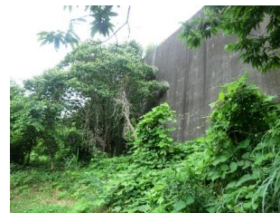
③B地区からA地区側・小田原厚木道路の擁壁を臨む。
