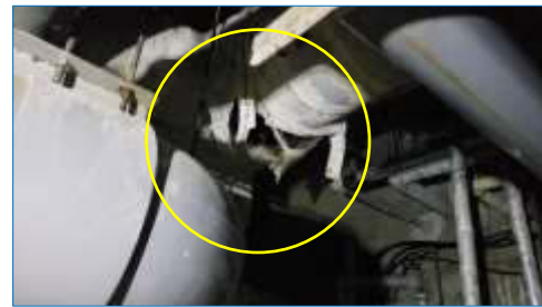
地下ピット内の破損したダクト
