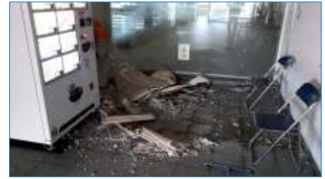
天井崩落現場(1階)
