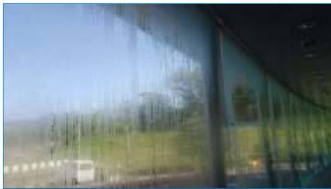
駐車場側通路(日常的にみられる結露)
