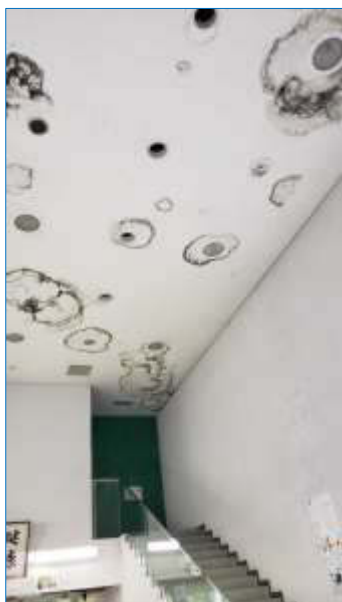
エントランス天井の染み
