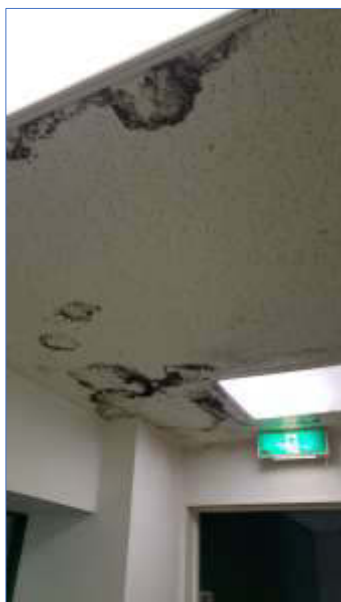
2階見学ロビー天井の染み
