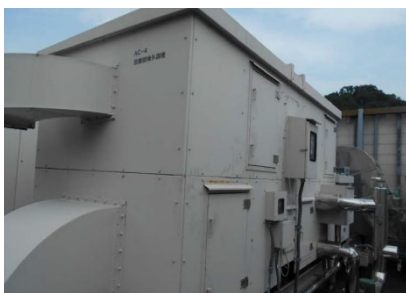
劣化した空調機
