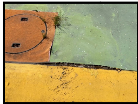
プールサイド 床シート劣化
