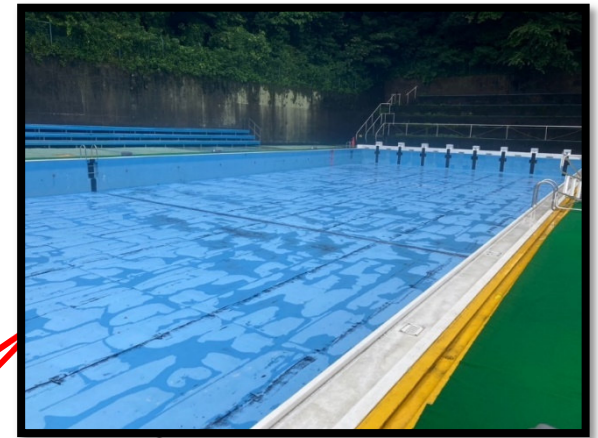
プール槽 塗装薄れ
