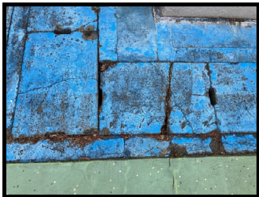
プールサイド 側溝蓋劣化
