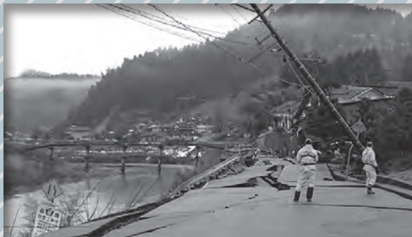
能登半島地震の被災状況(町消防隊災害派遣時撮影)
