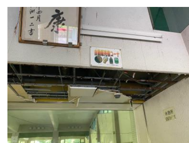
《天井崩落箇所》
