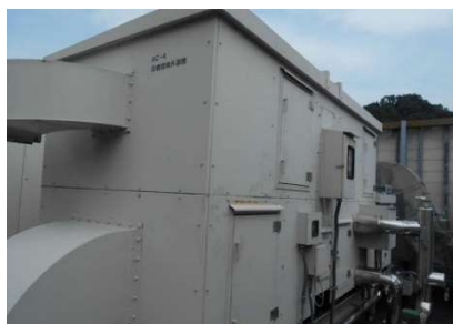
劣化した空調機
