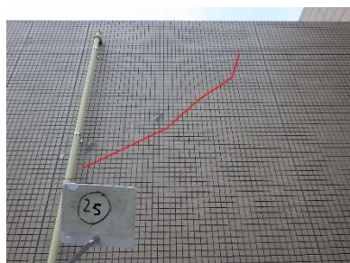
外壁のひび割れ(赤線部)
