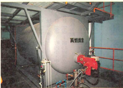
ごみを完全燃焼させる再燃焼室
