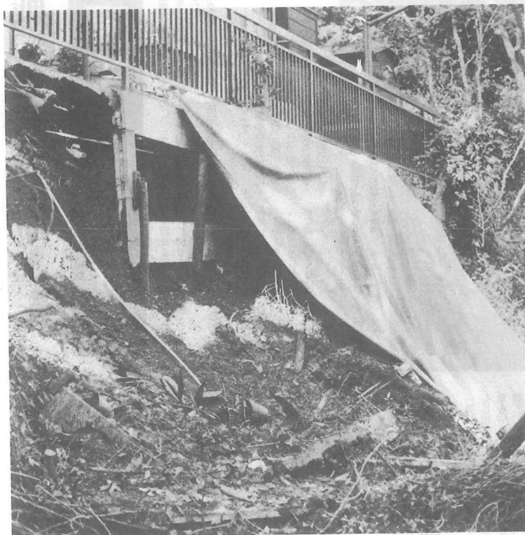
昭和57年9月12日、集中豪雨により発生した土砂くずれ（二宮・元町地内）
