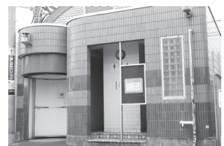
改善が急がれる老朽化した駅北口公衆トイレ
