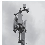
中里第1児童遊園地（ライオン公園）に設置されていた基地局（現在は撤去済）
