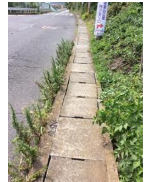
1級町道10号線:側溝のふたが歩道代わり、歩行者の通行に支障が
