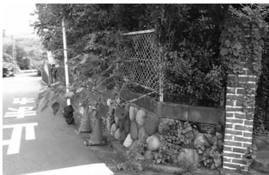
石垣が崩れた空き家は 台風時には心配の種
