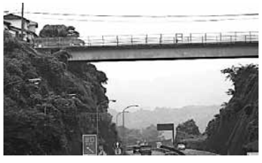
中里第一架道橋は建設から 50年、次年度改修予定
