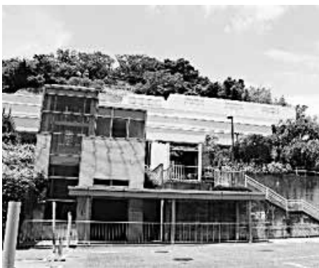
▲▶建物内部にひび割れがある町民センター
