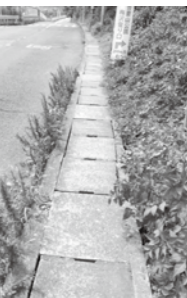
1級町道10号線：側溝のふたが歩道代わり、歩行者の通行に支障が
