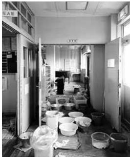
卒業式当日の 二宮中学校 雨漏り現場
