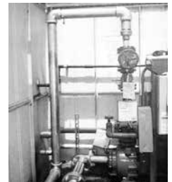
消火用ポンプ
