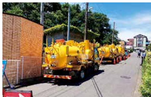
JR側道、コンビニ横の県排水ポンプ施設点検・清掃の様子
