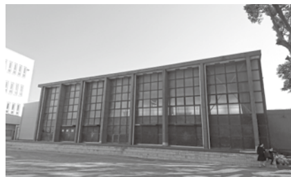
建設以来、40年以上一度も改修されていない二宮小学校体育館
