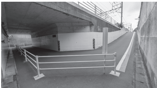
越地地区JR下のアンダーパス (松浦地下道)。 排水ポンプ機能点検は年4回実施
