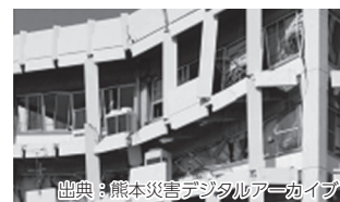
出典：熊本災害デジタルアーカイブ 地震で柱がすべて倒れ、押し潰された宇土市役所4階
