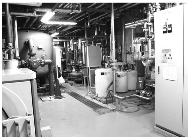
今後の活用方針は？ 休館が続く温水プールの機械室
