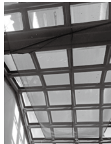
ひび割れ箇所が見られる町民センターの天井
