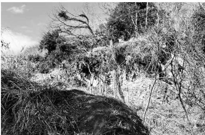
町民運動場下部の斜面崩落個所
