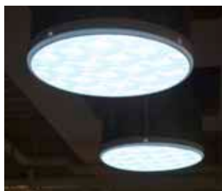
自然光を集光する光ダクトによる採光で室内は照らされている
